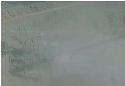
Gut sichtbar: Die Staubentwicklung durch das Brechen der Kalksteine ohne Wassereintrag
